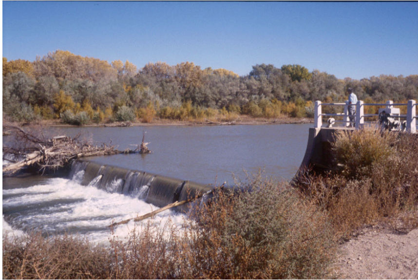
Una presa de desvío del distrito medio de conservación de Rio Grande cerca de Algodones Photograph by Letitia Morris
